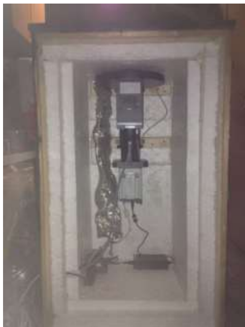
Рис. 171. Аппаратура в термостабилизированном контейнере
